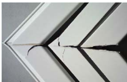
Фиг. 29 Видове дефекти на профилите
